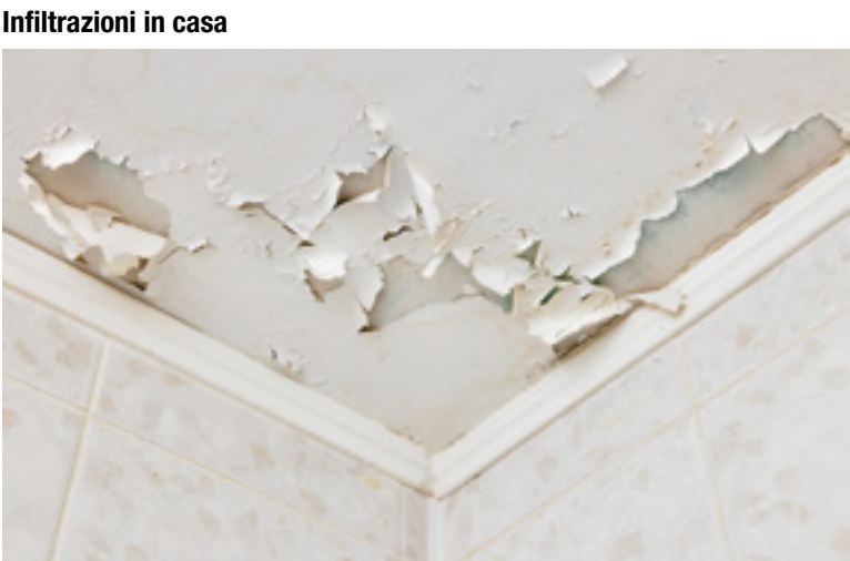
Infiltrazioni in casa
