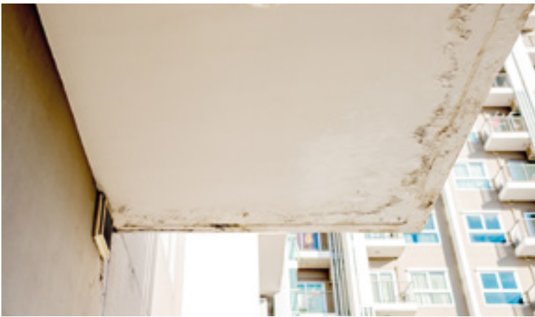
Infiltrazioni in balcone
